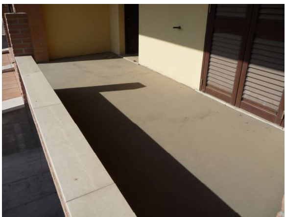
Foto 10=pavimento portico fronte p.t. (lotto 2)
